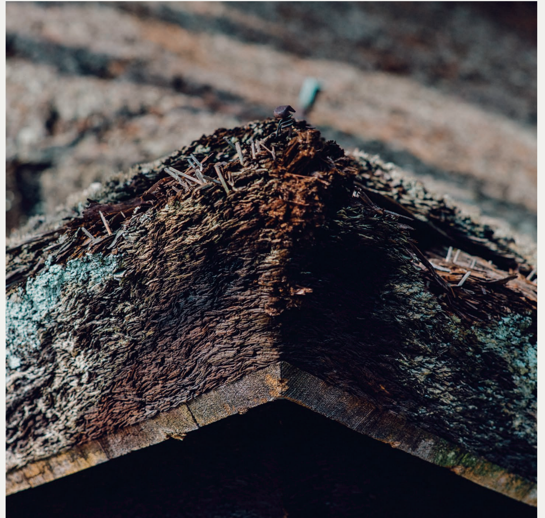
風雨により朽ちた本堂の檜皮葺屋根
